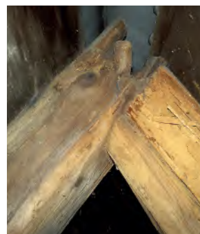
Der Firstpunkt muss beim Sparrendach zwingend trocken und intakt sein.
