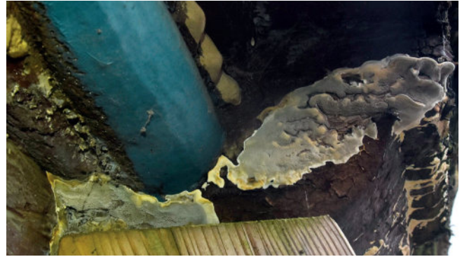
Fruchtkörper eines ausgebreiteten Hausporlings an einem tragenden Bauteil.
