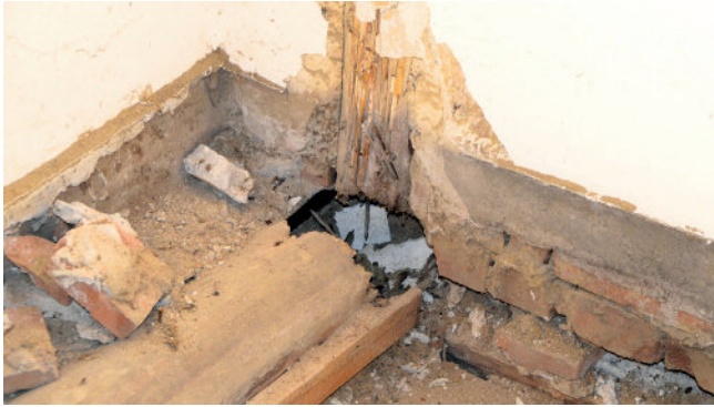
Schadbild Balkenkopf im Außenwand-Auflager.
