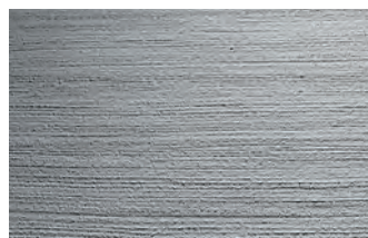
Besenstrichputz kam früher vor allem zum Einsatz, um Sockelzonen zu gliedern. Heute ist er auch an Hauptfassaden wieder gefragt.
